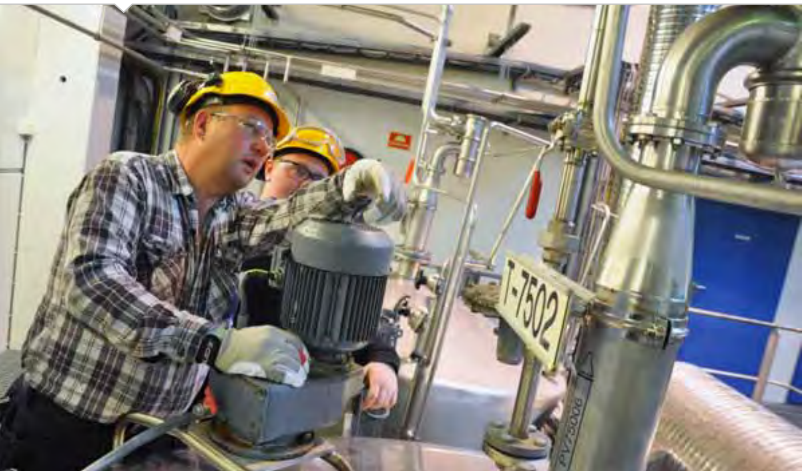
Anlegget må jevnlig etterses og da er det Jan Jevne (51) som trår til.
